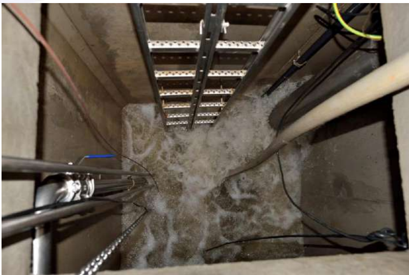
Razbremenilni bazen (Muljni bazen) med povratnim pranjem (v 23 sekundah 1 m 3 vode)
