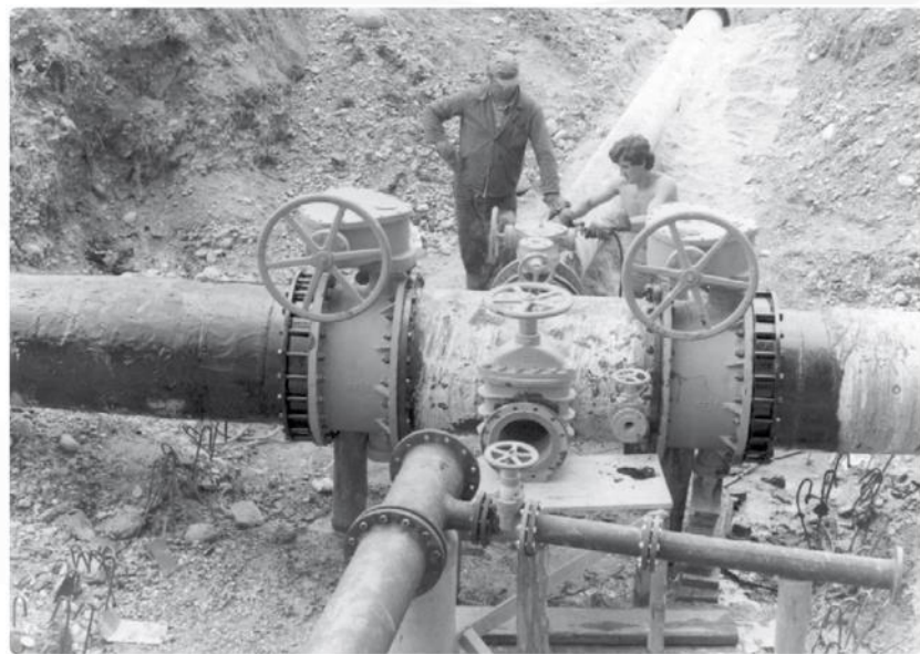
VOZLIŠČE CEVOVODOV NA TRŽAŠKI CESTI Z ELEMENTI ZA ZAPIRANJE PRETOKA VODE
